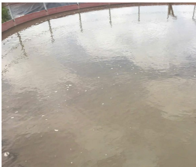
Bể lắng hóa lý
