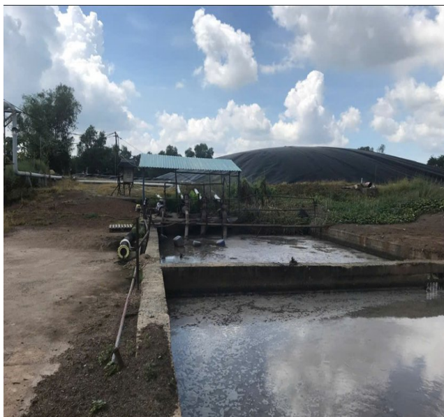
Bể điều chỉnh pH
