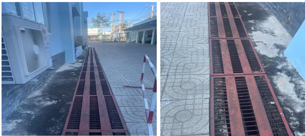
Hình 5 Mương, rãnh thu gom, thoát nước mưa của Trung tâm
