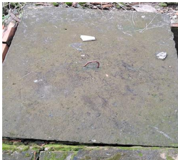
Hình 3. 4: Hố ga đầu nối thoát nước thải
