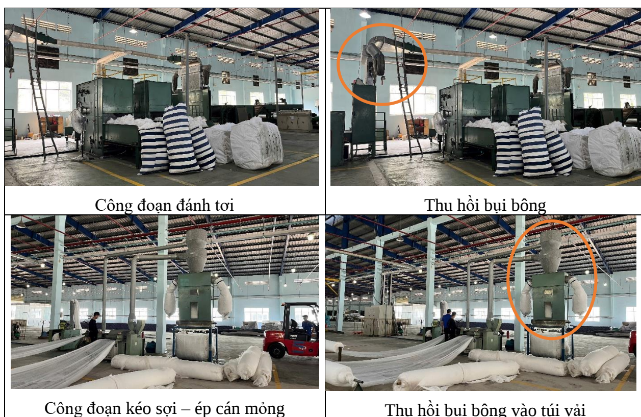
Hình 3. 6: Hệ thống máy hút bụi tích hợp trong dây chuyền sản xuất vải không dệt thu hồi bụi bông
