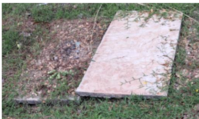
Hình 3. 2: Hố ga đầu nối thoát nước mưa
