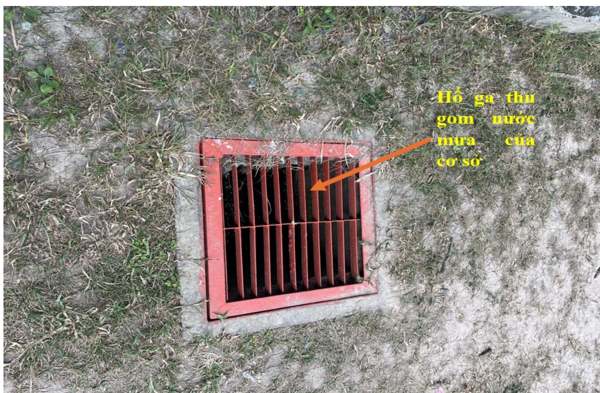
Hình 3. 3. Hố ga thu gom nước mưa của cơ sở
