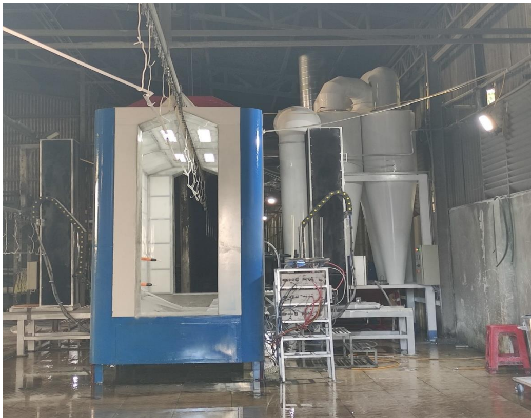
Hình 3. 6. Hệ thống phun sơn tĩnh điện và ống dẫn khí
