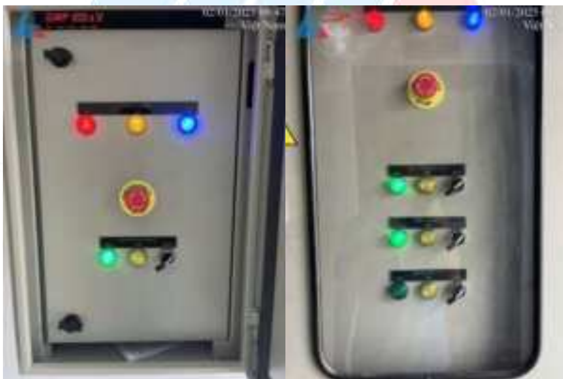
Hình 2.5. Tủ điện điều khiển ở chế độ AUTO tự động
