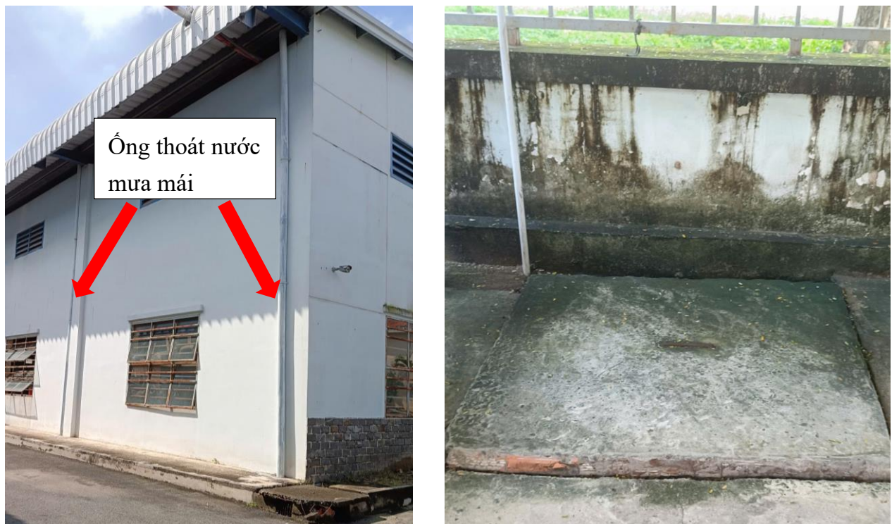
Hình 5 Hình ảnh hệ thống thoát nước mưa
