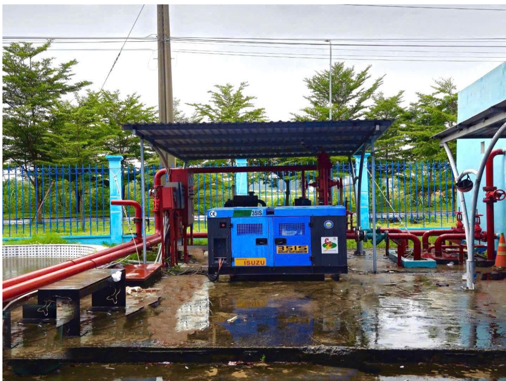
Hình III-6. Hệ thống PCCC tại cơ sở.
