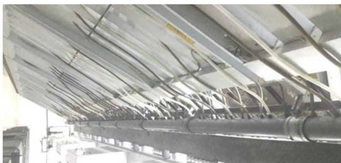
Các đường ống thu gom dầu đã tách
