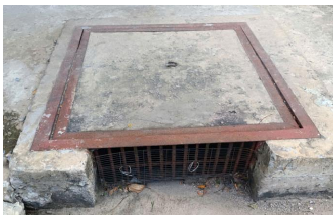
Hình 1.18. Hố ga thu gom nước mưa tại cơ sở
