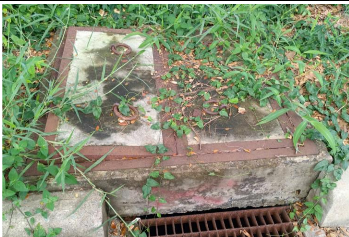
Hình 3.2. Hố ga đấu nối nước mưa với KCX & CN Linh Trung III
