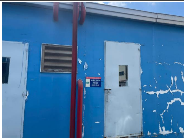
Hình 1.17. Trạm bơm tại cơ sở
