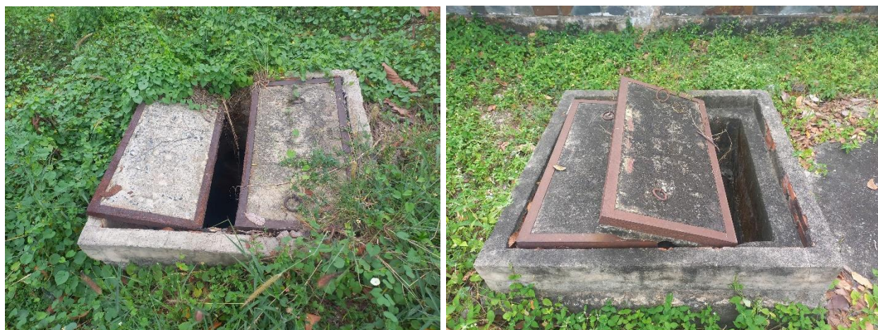
Hình 25. Hình ảnh hố ga đầu nối nước thải nhà xưởng 1 (trái), nhà xưởng 2 (phải)
