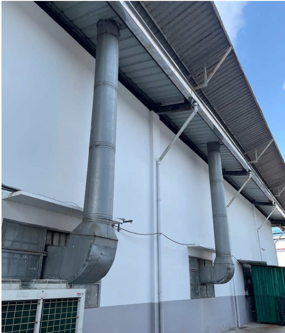
Hình 43. Hình ảnh ống thoát khí của các máy sấy nhà xưởng 1
