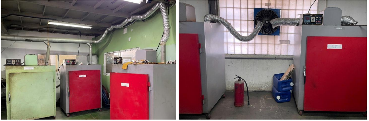
Hình 42. Hình ảnh thu gom nhiệt thừa từ các máy sấy nhà xưởng 1
