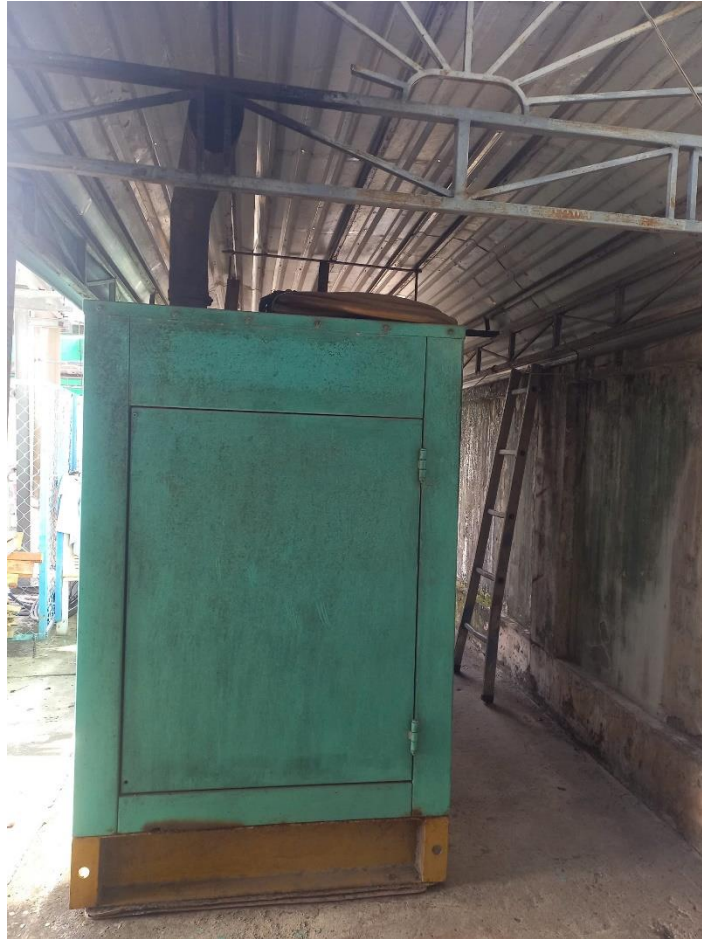
Hình 44. Ống khói khí thải phát sinh từ máy phát điện dự phòng
