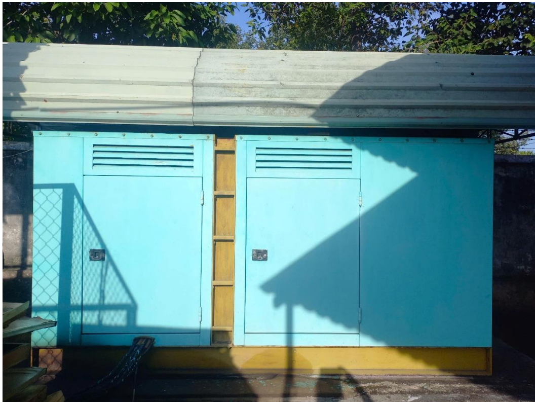
Hình 52. Hình ảnh máy phát điện dự phòng nhà xưởng 2
