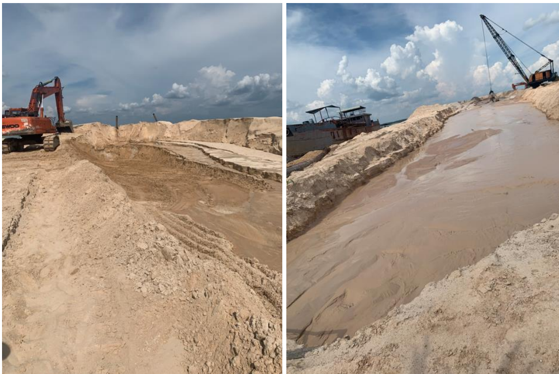
Hình 3.1: Mương thu gom nước thải tại bãi tập kết
